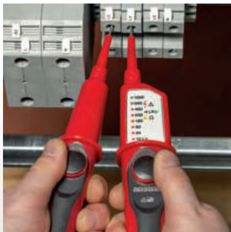
Drehfeldprüfung an den Ausgangsklemmen einer USV
