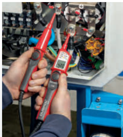
Prüfung der Ausgangsspannung einer DC-Ladeeinrichtung
