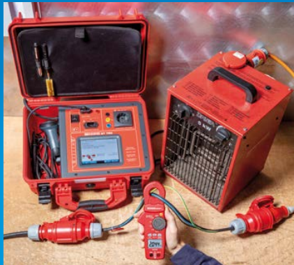
Differenzstrommessung an einem 3-phasigen Betriebsmittel über alle aktiven Leiter
