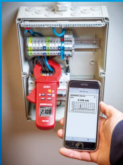
Fehlersuche in einer elektrischen Anlage und Protokollierung über App BENNING MM-CM Link
