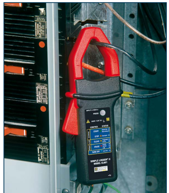
Einfache Erfassung des Stroms an einer Schalttafel
